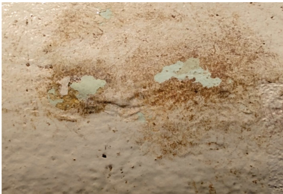
Figura 5 – Pintura. Tinta descascada revelando a existência de pintura anterior. Há, também, indício de oxidação ao redor do desgaste pictórico. Curitiba setembro de 2019
