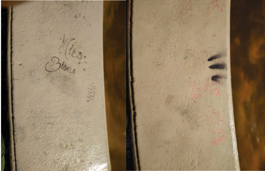
Figura 2 – Depredação. Registro de pichação e depredação realizada com materiais variados que são absorvidos pela rocha. Curitiba, setembro de 2019
