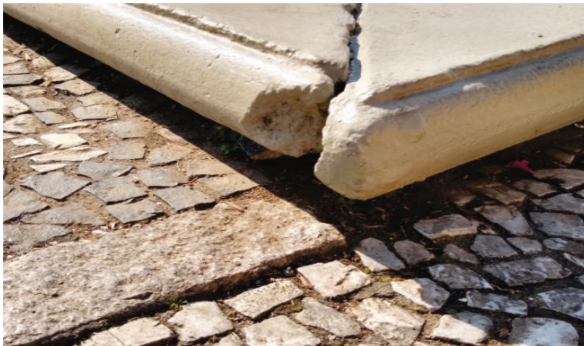
Figura 4 – Fratura. Danos na extremidade do monumento, formando desalinhamento da estrutura. Curitiba setembro de 2019
